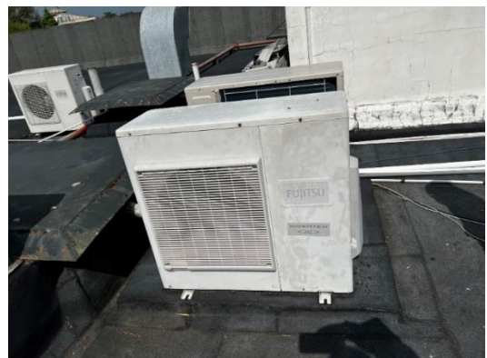
Hình 8. Hệ thống làm mát (Thực địa)
