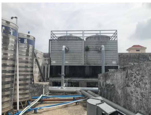
Hình 13. Hệ thống ngưng tụ trên mái
