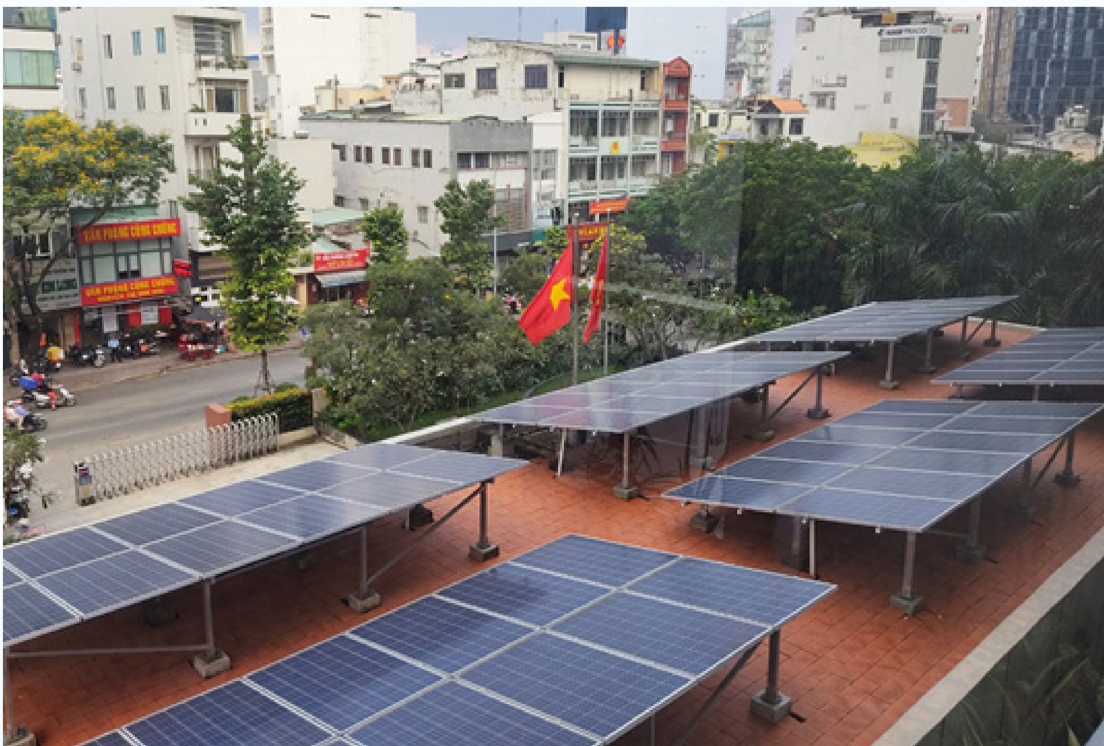
Hệ thống điện mặt trời tại Trung tâm hành chính Quận 4, thành phố Hồ Chí Minh. Ảnh: Tạp chí Công thương
