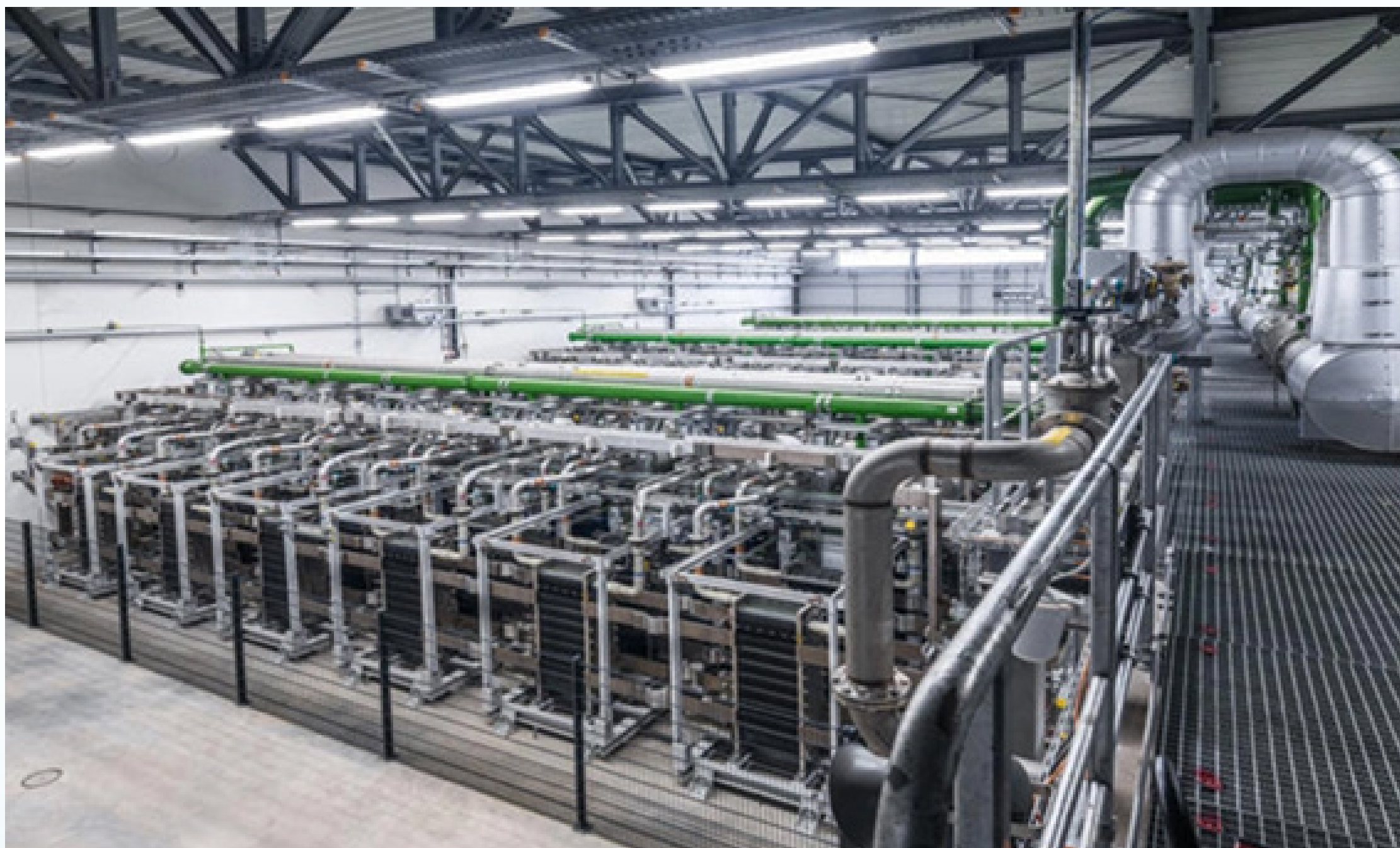
Máy điện phân PEM 54 MW. Ảnh: BASF
